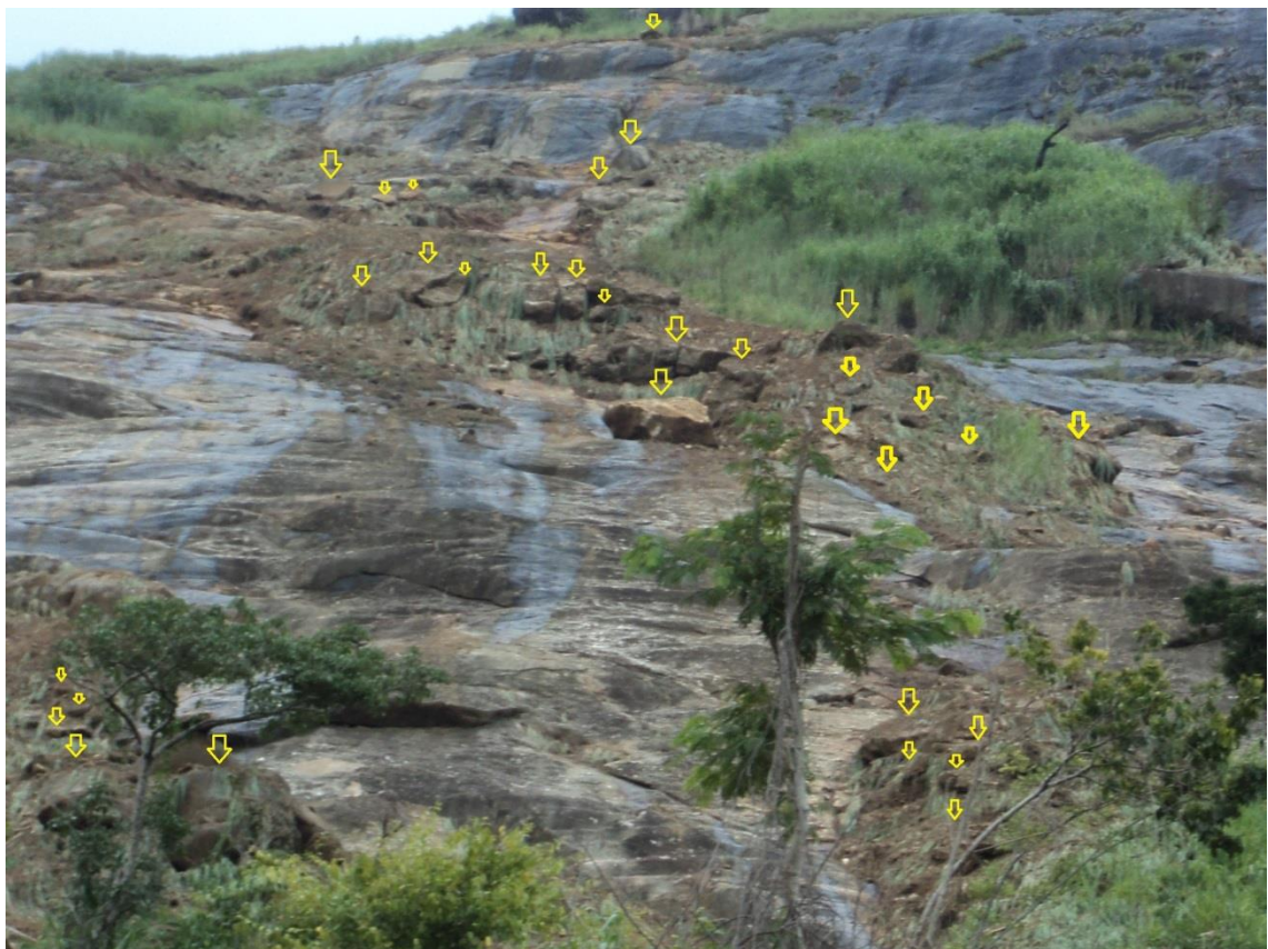
Figura 17: Queda e escorregamento de blocos e matacões em encosta no bairro Ipanema, Viana (Es), março 2011. Foto da autora.
